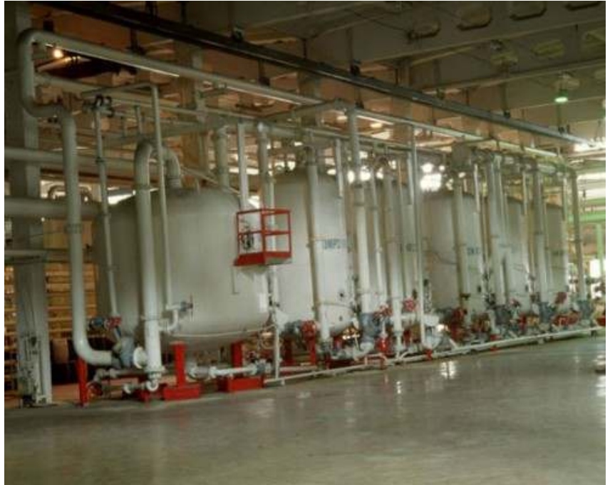
Центральний зал хімоводоочищення
