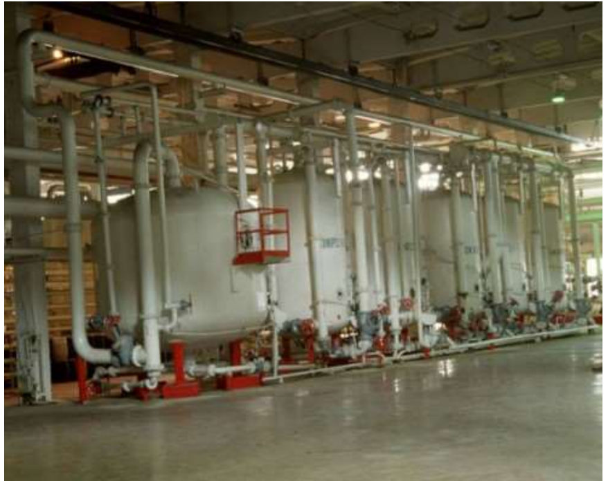
Центральний зал хімоводоочищення
