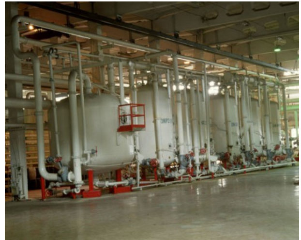
Центральний зал хімводоочищення
